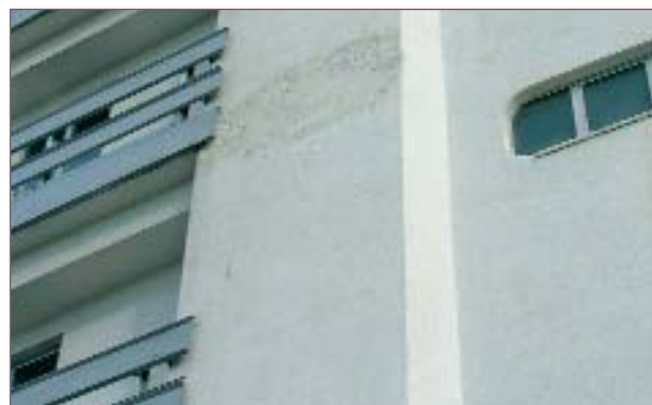
Rapprezzo "a rilievo" effettuato con malta di granulometria differente rispetto all'esistente. La successiva pitturazione evidenzia il difetto.
