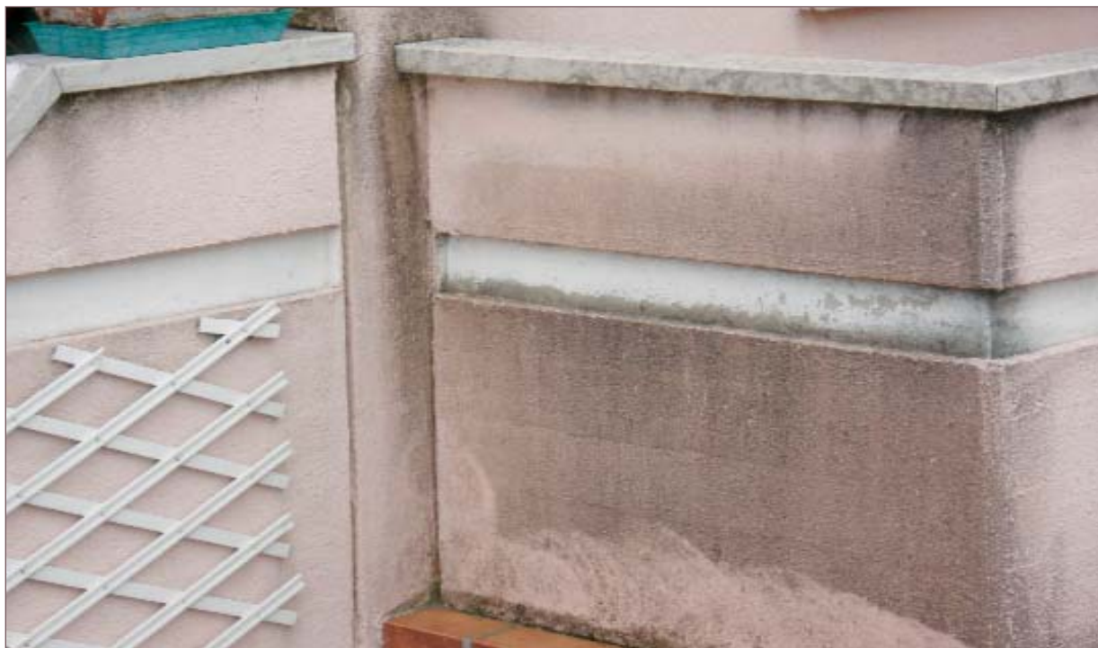
Formazione di muffe dovute al continuo percolamento e infiltrazione di acqua piovana
