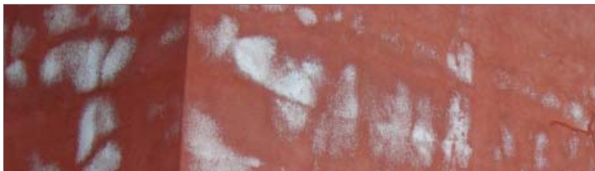
Dimostrazione reale di una superficie esterna con blocchi di muratura umidi ed efflorescenze
