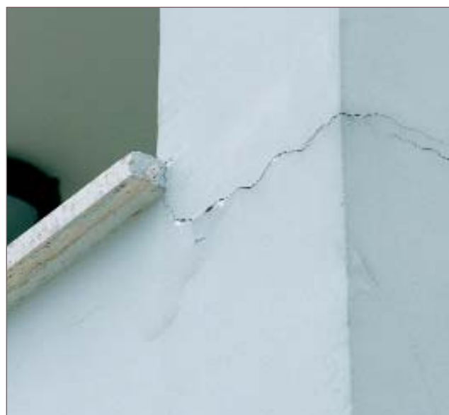
Cavillatura strutturale su terrazzo
