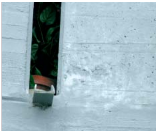
Efflorescenze su cemento armato dovute ad infiltrazione di acqua dalla pavimentazione e assorbimento del supporto molto poroso
