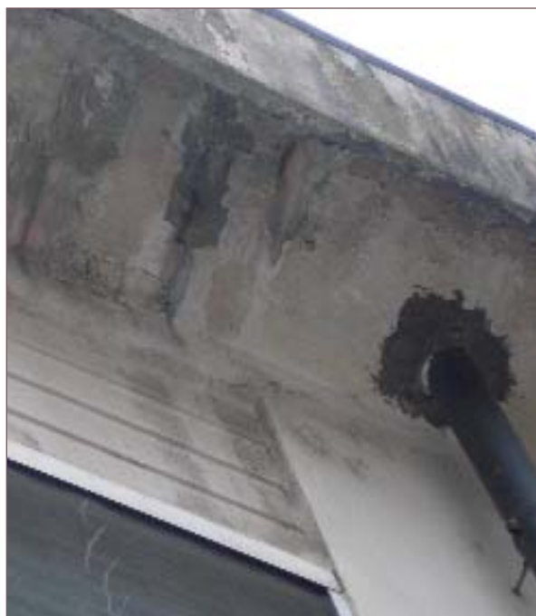
Infiltrazioni di acqua dalle coperture, con rottura e disgregazione del supporto anche a causa dell'ossidazione dei ferri di armatura
