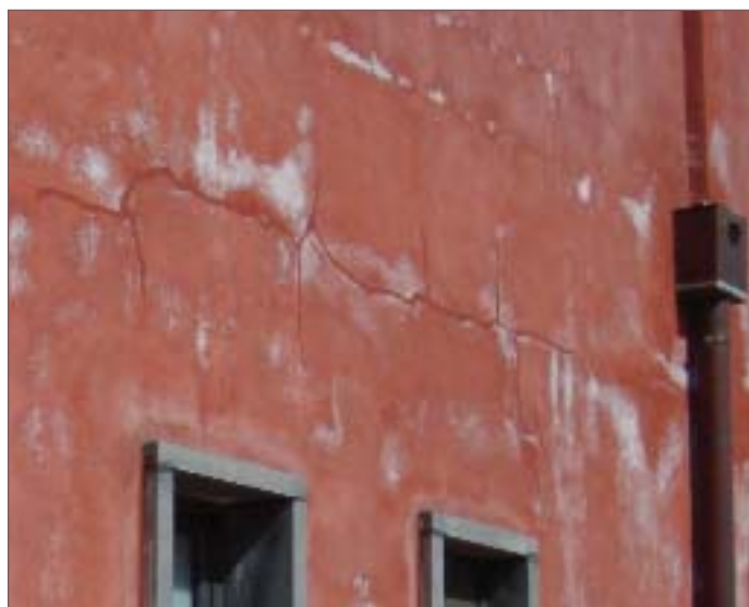
Formazione di cavillature in prossimità della malta di muratura
