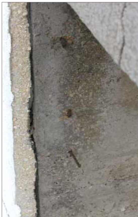
Distacco intonaco da cemento
