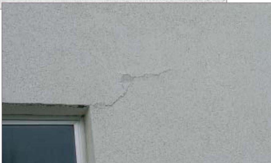
Cavillatura strutturale a 45° in prossimità di finestra. Distacco superficiale dell'intonaco di finitura.
