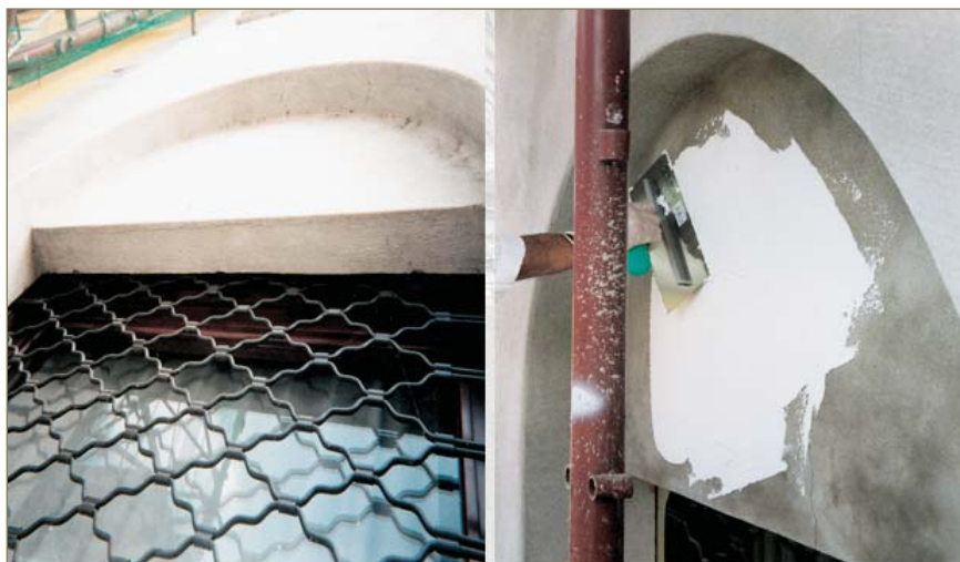
Ripristino di una superficie con crepe utilizzando RASANTE MINERALE bianco e RETE IN FIBRA DI VETRO
