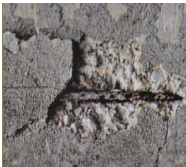
Degrado del calcestruzzo armato, affioramento dei ferri d'armatura, distacco copriferro
